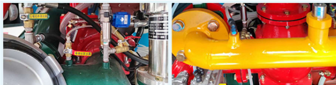
MONITOREO DE PRESIÓN EN CAÑERÍAS DE AGUA
