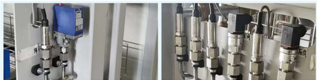
EQUIPAMIENTO DE REFRIGERACIÓN DE AIRE ACONDICIONADO
