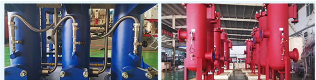
MONITOREO DE PRESIÓN EN FILTROS
